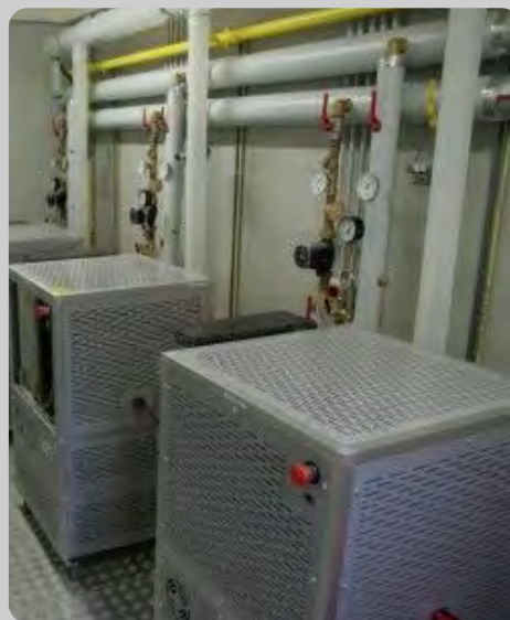
Centrale termica cogenerazione 116kw
